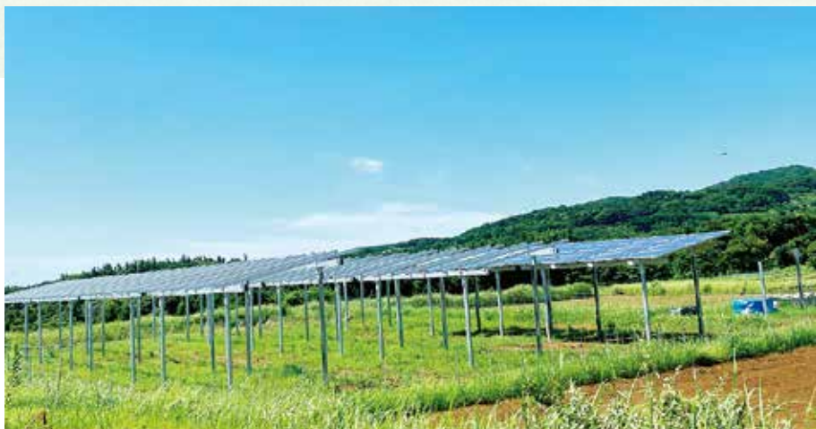
飯良地区に設置された太陽光パネル
